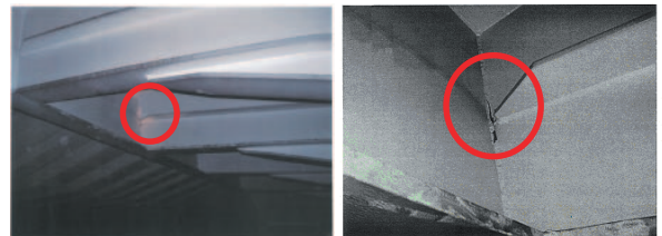
図18 片持梁構造のウェブとハッチサイドガーダとの取り付け部のすみ肉溶接部における損傷
