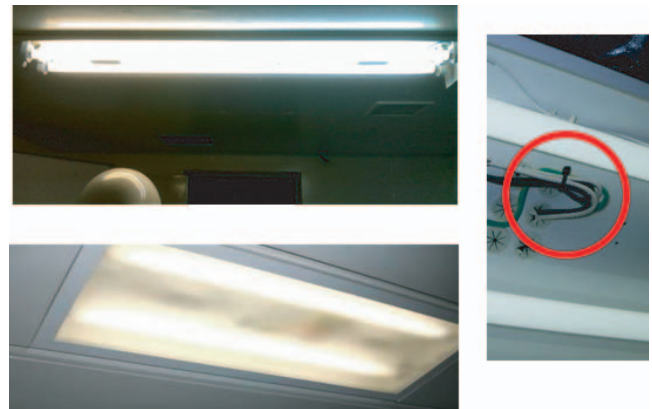
図21 電灯器具及び内部配線
