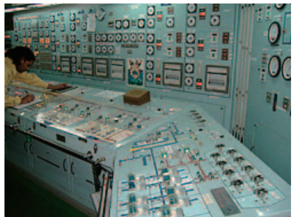
図12 荷役集中監視制御設備の例
