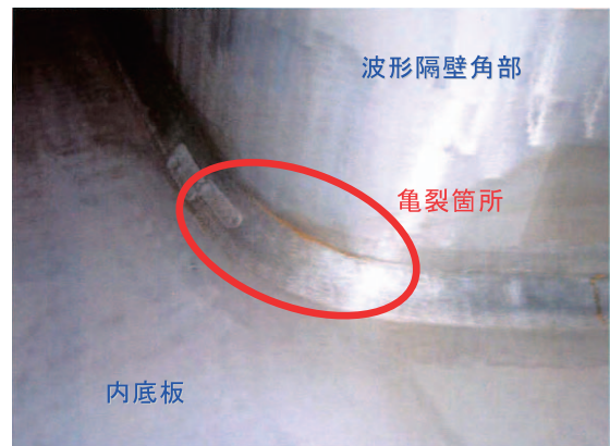
図 1 溶接部の亀裂損傷の一例
