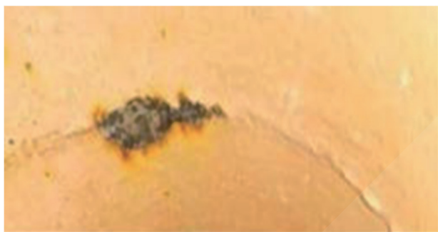
図5 ディスタンスピース内の突合せ溶接部近傍の塗装の剥離
