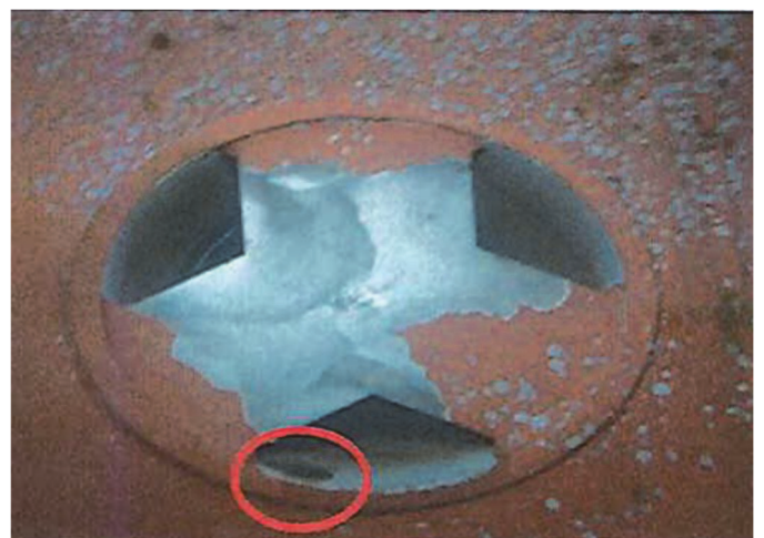
図3 ディスタンスピースとブラフボディとの溶接部近傍の腐食
