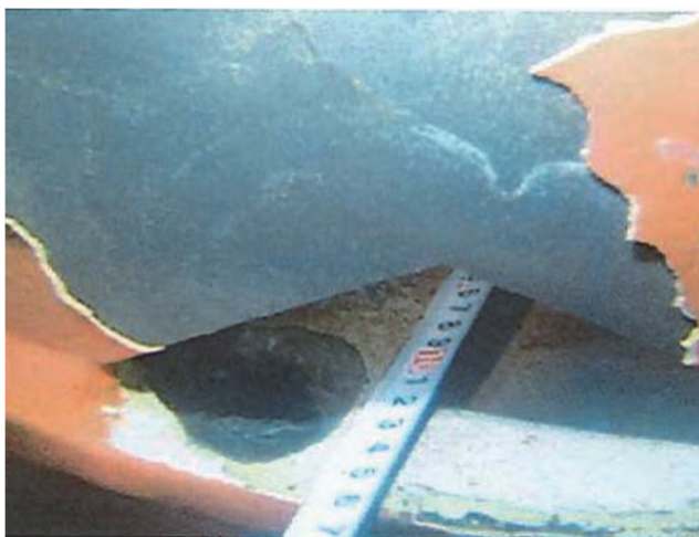
図4 ディスタンスピースとブラフボディとの溶接部近傍の腐食
