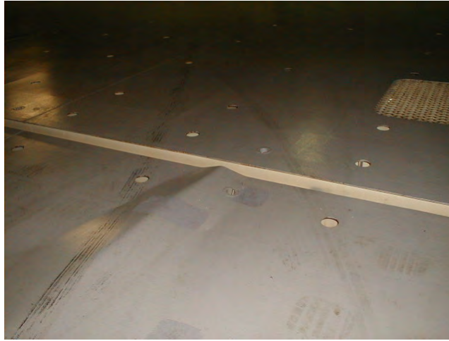
写真 2.車両甲板の座屈
