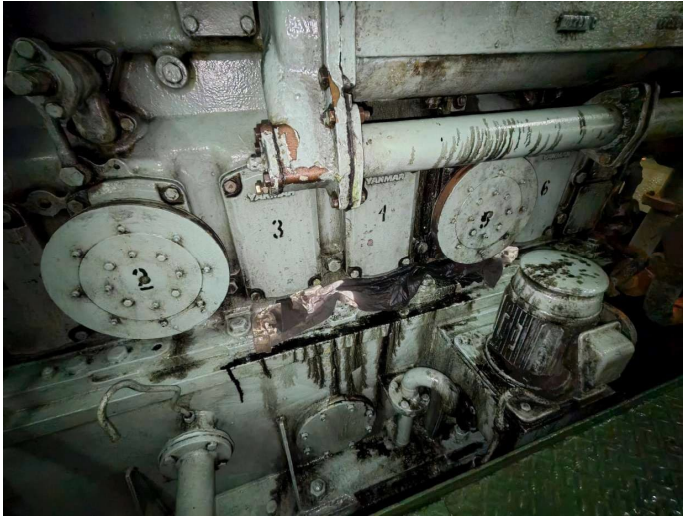
機関室原動機からの油の漏洩・蓄積
