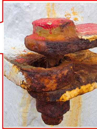
鋼製風雨密扉の腐食・破損
