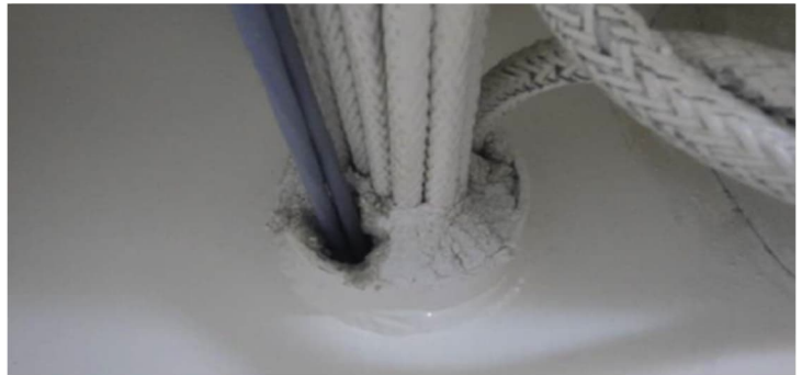
電線貫通部におけるコンパウンド 欠損(不適切な改造)
