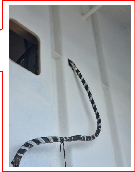
電線の無断追設と囲壁貫通
