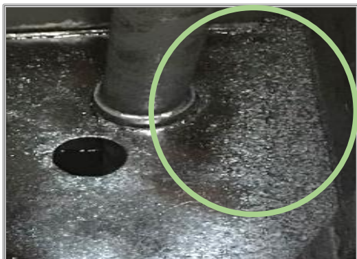
タンク内壁と床面の間に見られる堆積スラッジ
