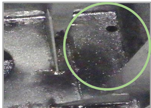
清浄が保たれたタンク内壁。
