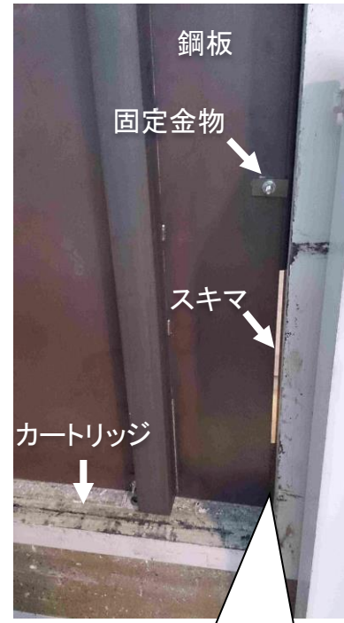
カートリッジと試験体の間に隙間がある
