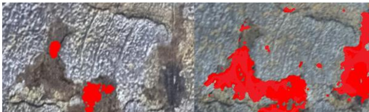
図 5.2.4 a7R2 のハッチを閉じた状態（左側）と開けた状態（右側）同じ部分の診断結果比較
