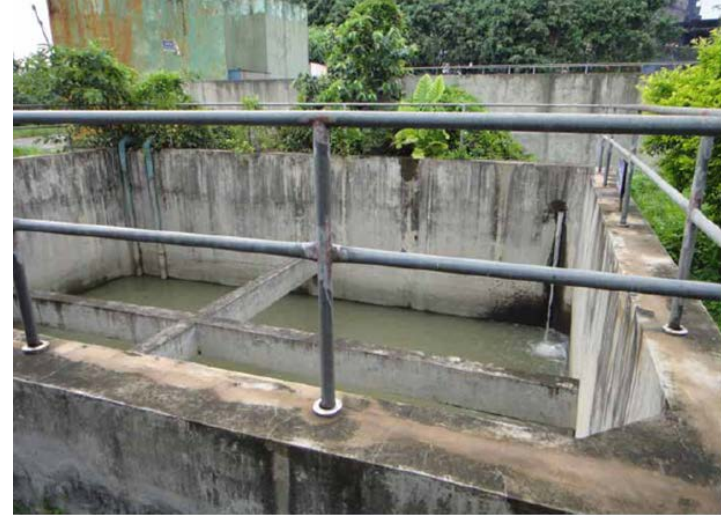
油汚水処理設備
