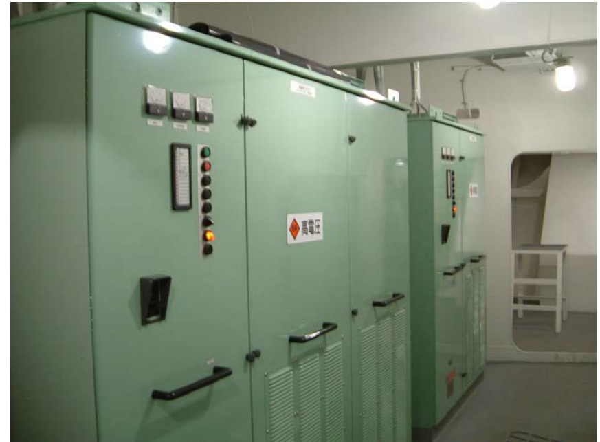
ブロウ制御用インバーター盤
