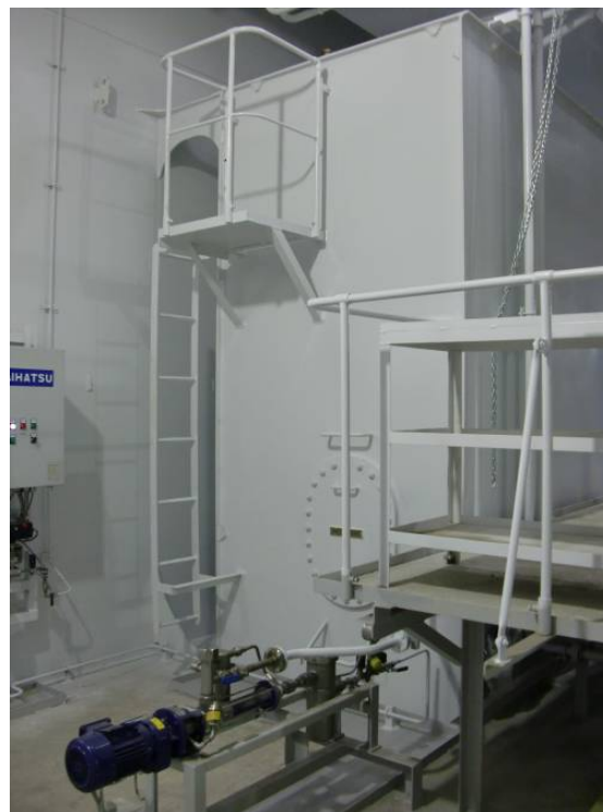
上: 尿素水タンク 下: ポンプ
