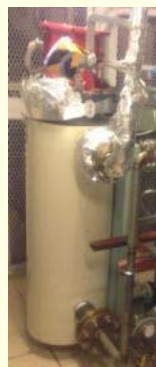
電気ヒータ（熱交換機代替）
