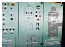
(信号・照明の点灯表示盤)
