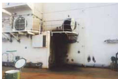
※排ガスの放出先の例 (閉囲区画ではないが人的被害の危れあり)
