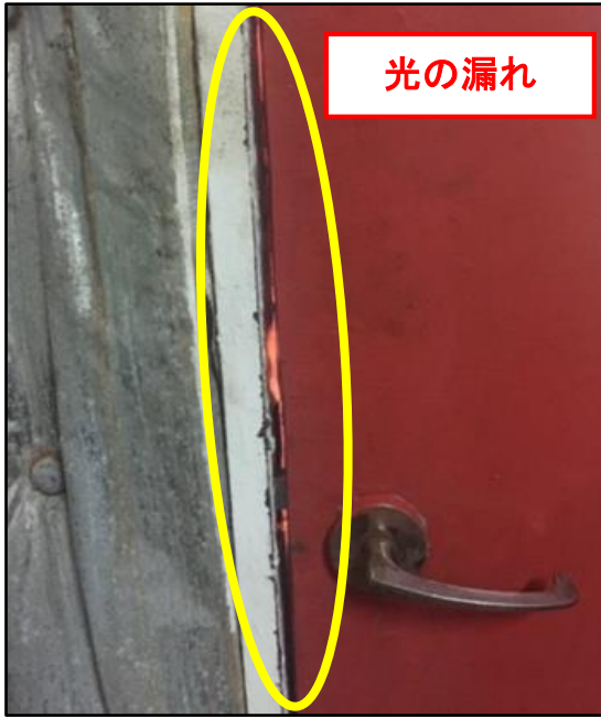
防火戸の隙間
