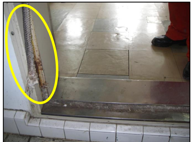
パッキンの脱落
