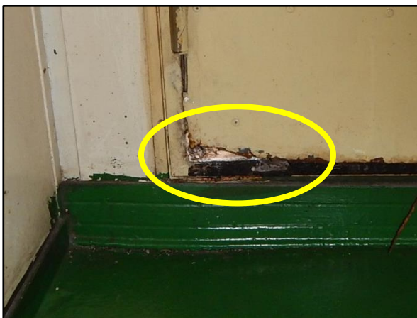
防火戸の腐食
