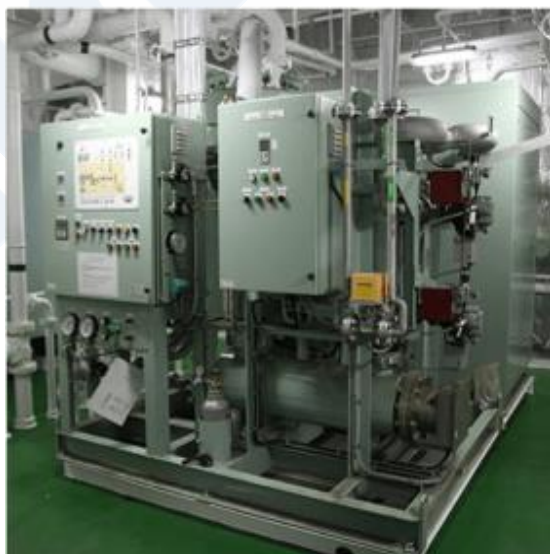
図 1.13 膜式窒素ガス発生装置（株式会社カシワテック提供）
