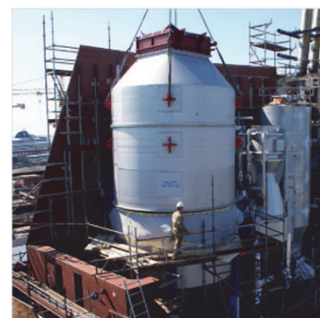
アルファ・ラバル殿提供 EGCSの例
