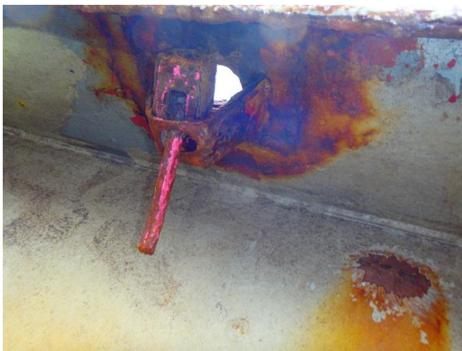
貨物艙ハッチカバーのクリート損傷
